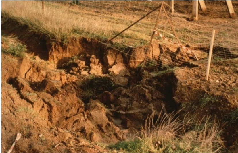
Fig. 3. Troubles rencontrés lors d'excavation soumises aux précipitations.
