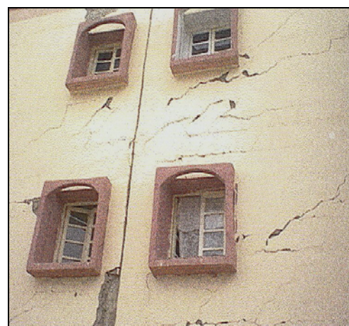
Photo 3 : Fissures à l'extérieur dues au tassement différentiel
