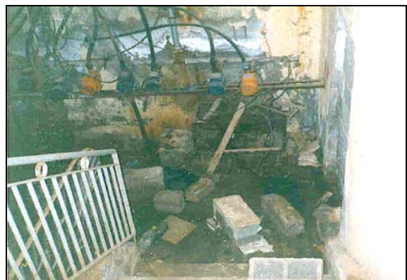
Photo 7 : La stagnation des eaux dans les caves
