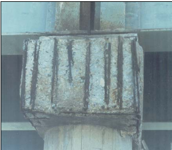
Photo 5 : Corrosion des armatures
