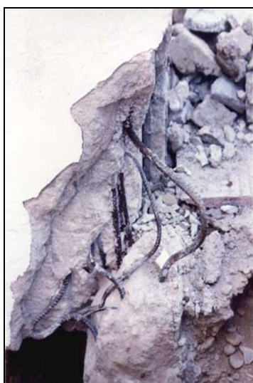
Photo 1 : Ecrasement de l'amorce poteau bloc n°15
