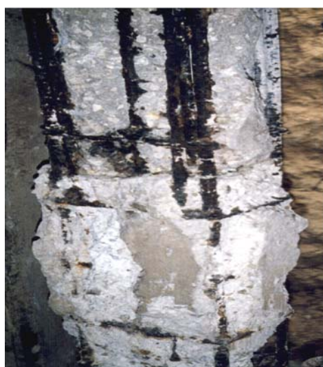
Photo 2 : Corrosion accélérée des amorces poteaux
