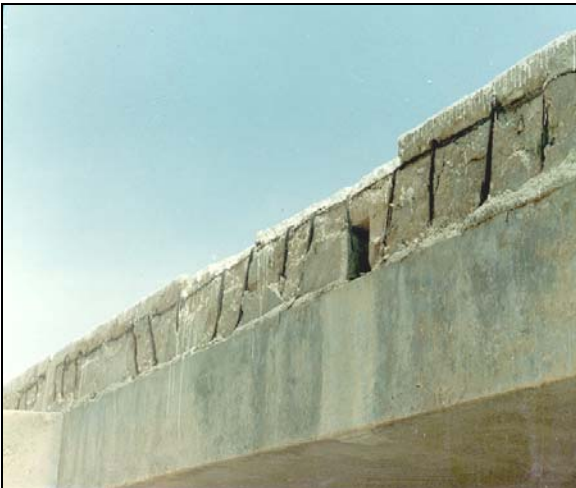
Photo 4 : Dégradation de l'enrobage de la bordure
