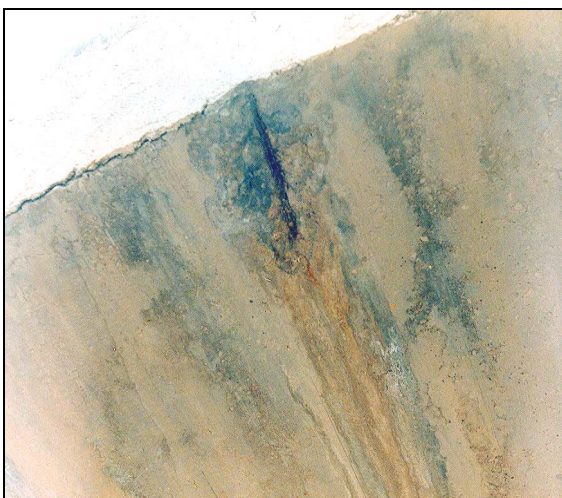
Photo 6 : Apparition des armatures corrodées
