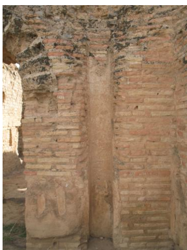
Figure 07: descente des eaux pluviales
